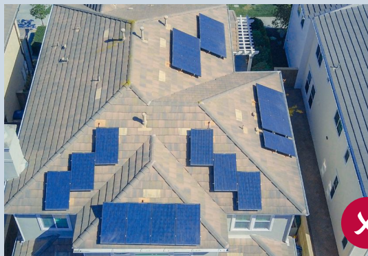
keine Zusammenfassung von Kollektoren erzeugt unruhige Dachlandschaft
