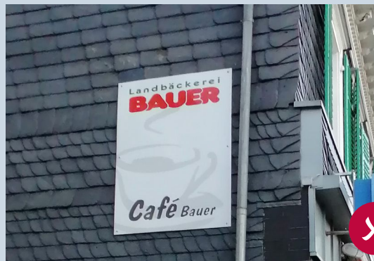
großformatiges Hinweisschild ohne Abstimmung auf die Fassade
